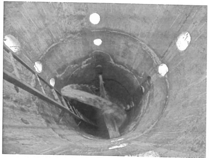
图 3.2.2.1-2 排洪系统排水井内景
