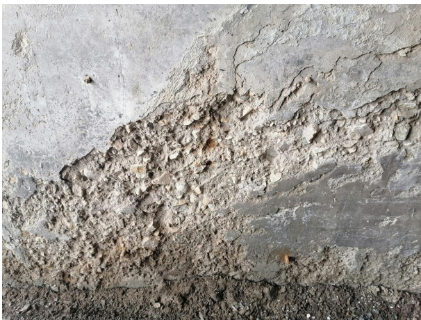
图 3.2.2.3-1 洞口处混凝土浆面脱落, 石子外露, 长度 25m
