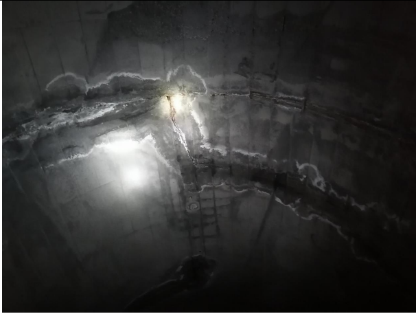
图 3.2.2.2-7 2100 米处, 拱顶露筋
