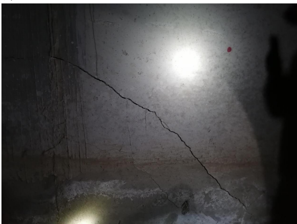
图 3.2.2.2-5 2650 米至 2750 米之间, 斜向裂缝, 宽 10mm, 深度大于 80mm
