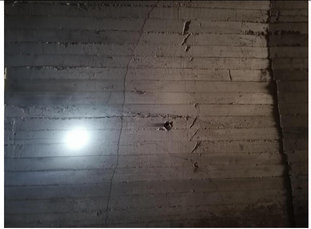
图 3.2.2.2-8 4 号支洞, 1400 米处开裂
