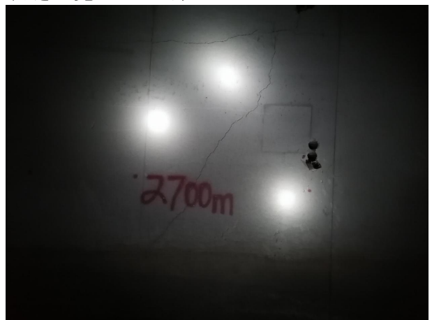
图 3.2.2.2-6 2700 米处裂缝, 宽 2mm, 深 30mm
