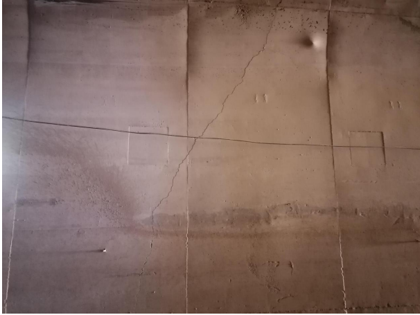
图 3.2.2.2-1 3440 米处边墙至拱顶环状裂缝, 宽 2mm, 深 15mm
